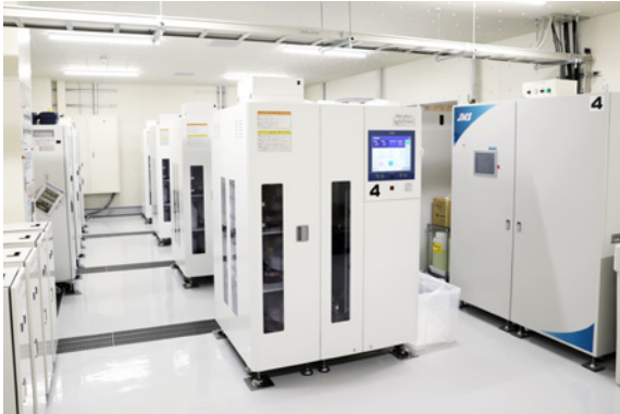
透析機械室には各種装置を4台ずつ配備
