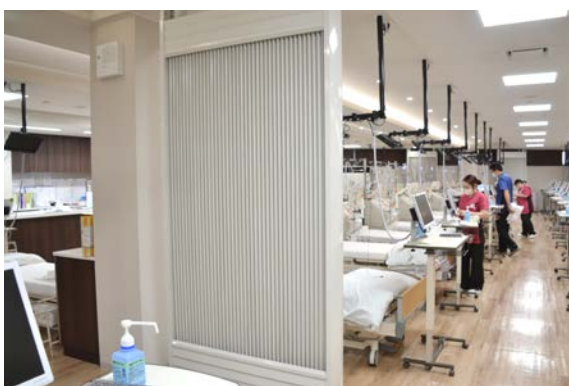
透析室には最新式の光冷暖房機器が設置されている。自然界と同じ輻射・放射による冷暖効果があるため、エアコンの当たりすぎによる体のだるさ、肌の乾燥、喉の痛みなどがない
