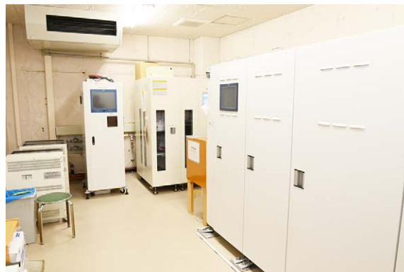
外来透析室に隣接した機械室に最新機器が並ぶ
