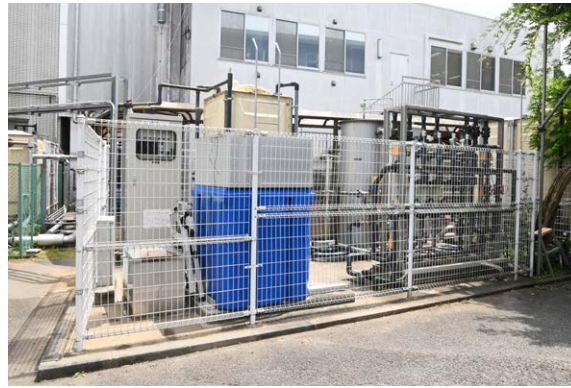
地下水濾過システム。湧水を基本に必要なに応じて水道水も使えるようになっている
