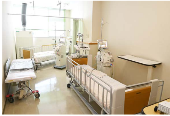
コロナ禍に新たに陰圧装置を設置した隔離透析室
