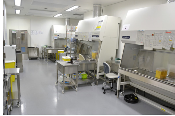
薬剤部のミキシングルームは、通院治療センターと直接つながっている。看護師から患者の投与状況が随時共有され、最短かつ適切なタイミングで薬剤を供給できる
