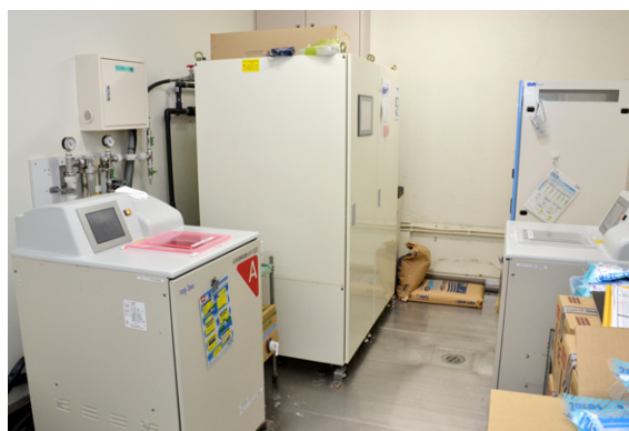
機械室は透析室の隣にある
